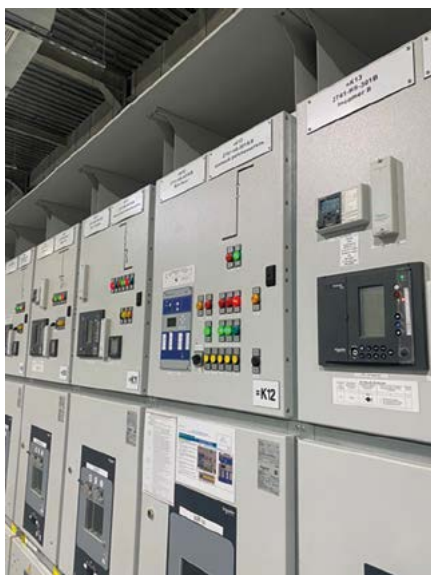
Рисунок 1. Шкаф с БАВР.
